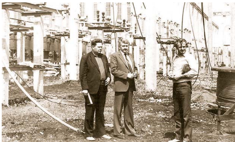
Я. А. Наконечний (у центрі) на підстанції «Західноукраїнська» 750 кВт, м. Ходорів
