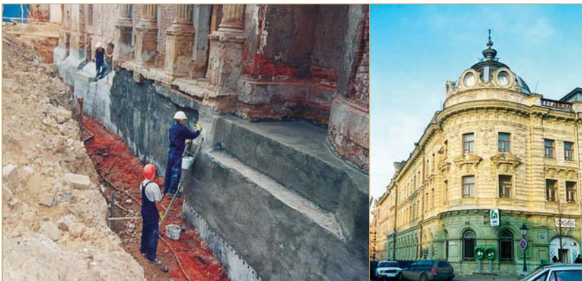
Санація Олександрійського пасажу (до і після ремонту, автор — ст. викл. Б. Л. Назаревич), м. Казань, Російська Федерація
