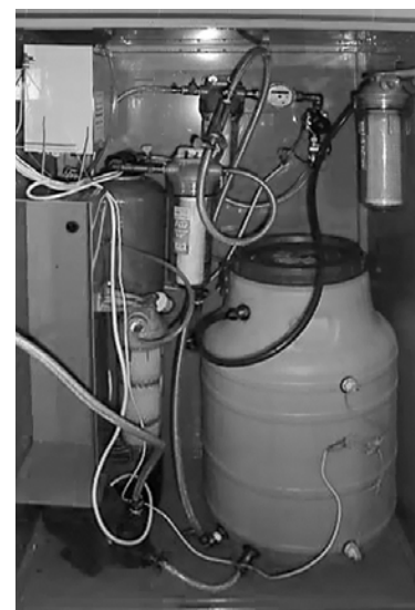
Апаратура водоочисної установки
